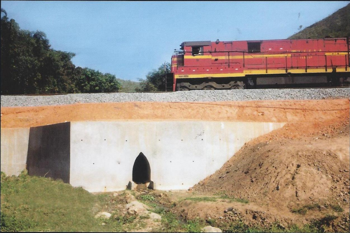
Bueiro de águas pluviais em Barra do Pirai - RJ Cliente: Rede Ferroviária Federal (RFFSA)
